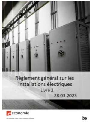
Installations à HT
